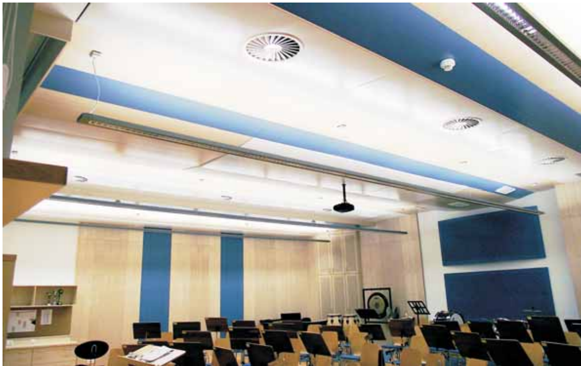
Thermische Behaglichkeit, kombiniert mit perfekter Optik und Akustik - SMARTLINE - Segel als Gestaltungselemente in einem hochwertigen Orchester-Proberaum
