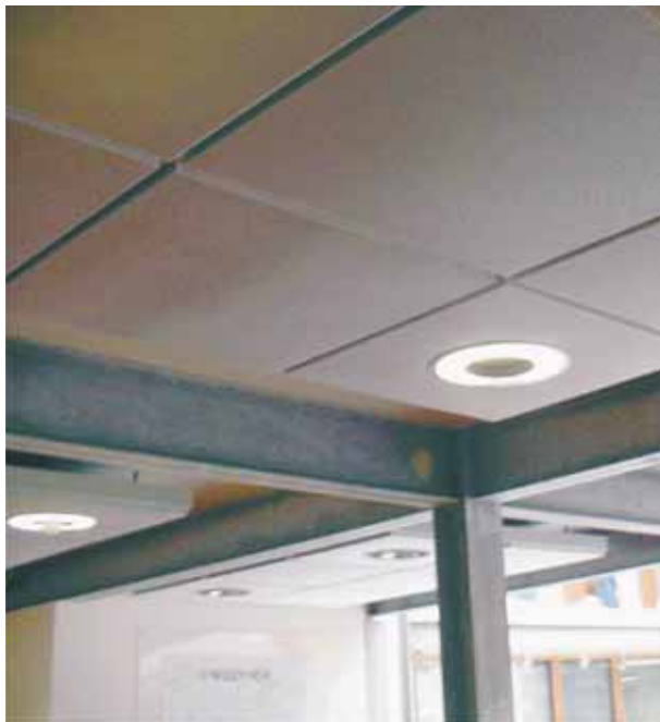
Herausragende Gestaltung der Kühldecke mit einer Streckmetall-Untersicht
