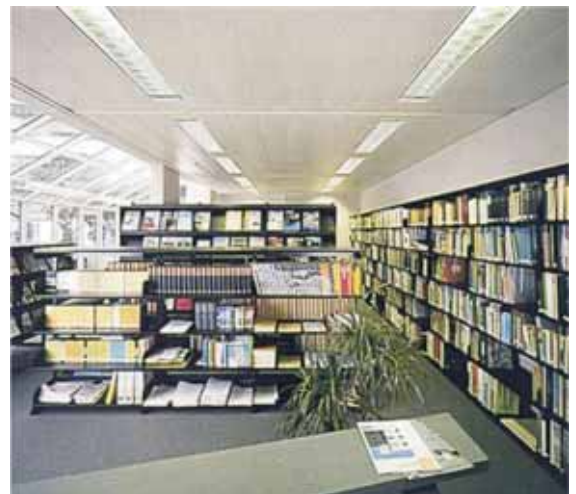
Bandraster-Langfeldkassettendecke zum Heizen, Kühlen und Lüften in einer Bibliothek
