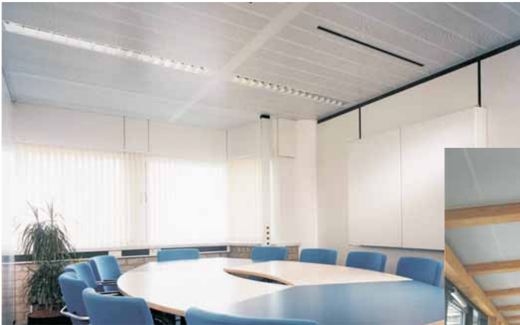
Beste Integration der aktiven Kassettendecke in die Gestaltung des Architekten
