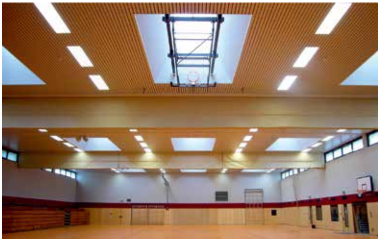
Vollflächige Deckenstrahlungsheizung von Wand zu Wand
